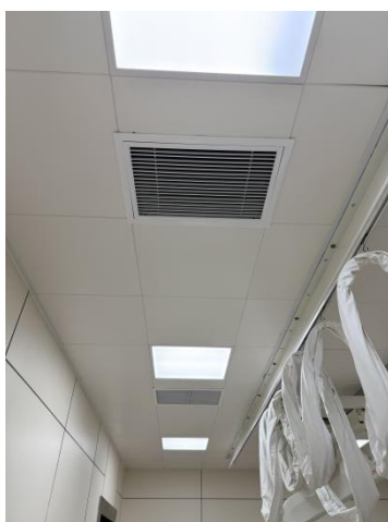
中部常规排风口
