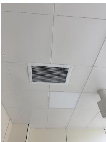
中部新风排风口
